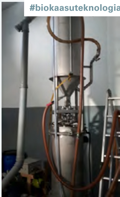
Kuva 1. Koeajoissa käytetty EI-Water laitteisto
